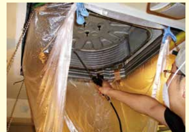
▲エアコン洗淨中
